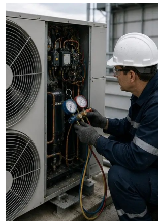
Foto №6. Zustand der HLK-Ausrüstung dokumentiert
