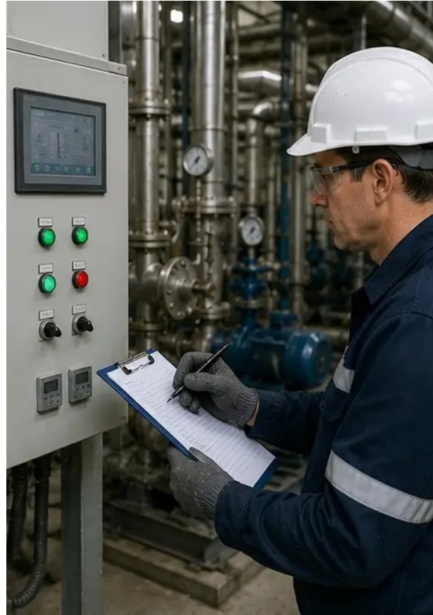
Foto №14. Abschließende Wartungsüberprüfung durchgeführt
