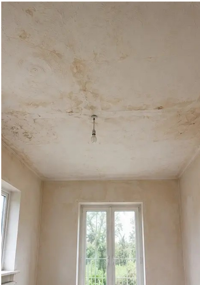
Foto №7 Zustand der Decke vor der Renovierung
