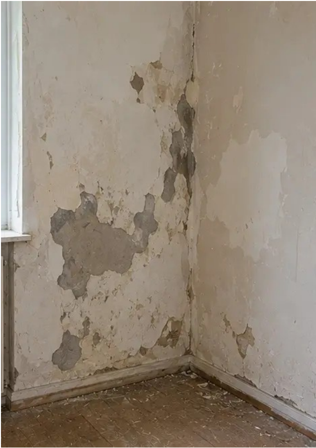
Foto №3 Zustand der Wand vor den Reparaturarbeiten
