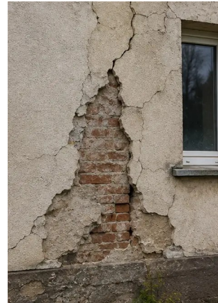
Photo #4. Außenwandschaden zur Bewertung dokumentiert
