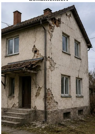
Photo #15. Übersicht mehrerer Schadensstellen
