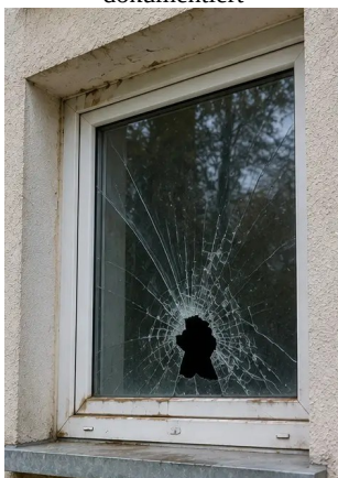
Photo #7. Beschädigtes Fenster zur Begutachtung dokumentiert
