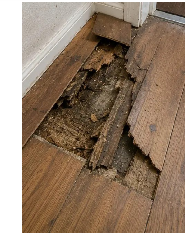
Foto №9 Beschädigter Bodenbelag bei der Inspektion dokumentiert
