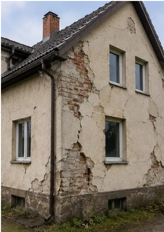
Foto №2 Übersicht der bei der Inspektion dokumentierten Außenschäden
