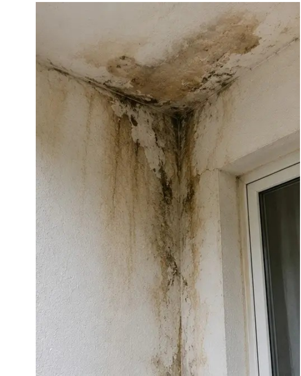
Foto №6 Wasserschadenbereich identifiziert und erfasst
