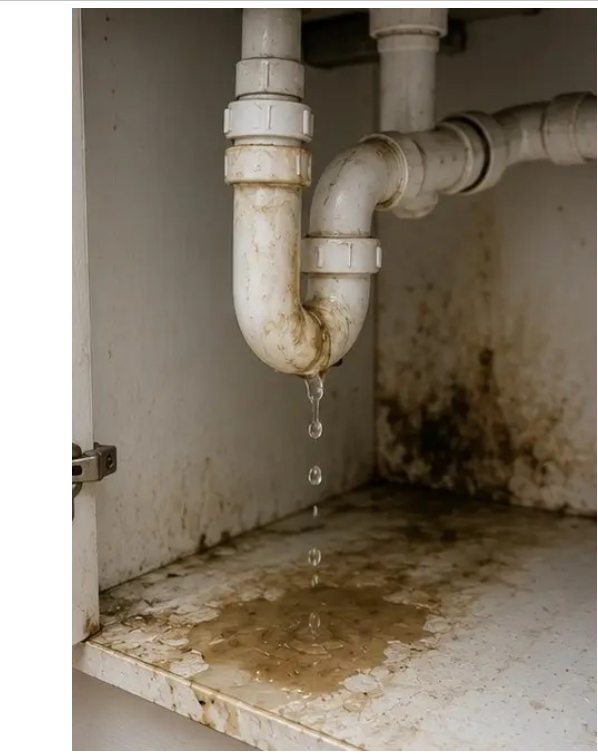
Foto №11 Schaden durch Rohrleitungsleckage dokumentiert
