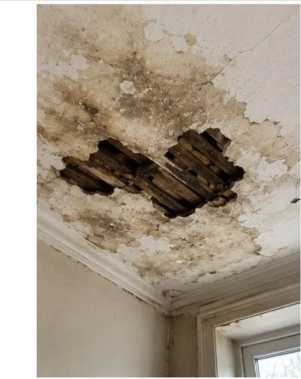
Foto №10 Deckenschaden identifiziert und erfasst
