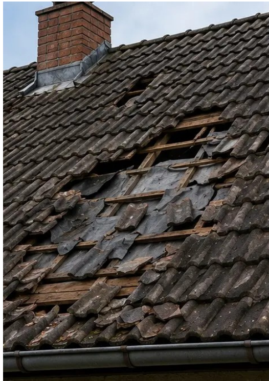
Foto №3 Beschädigter Dachbereich identifiziert und erfasst
