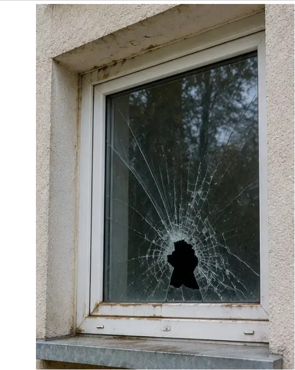
Foto №7 Beschädigtes Fenster zur Begutachtung dokumentiert
