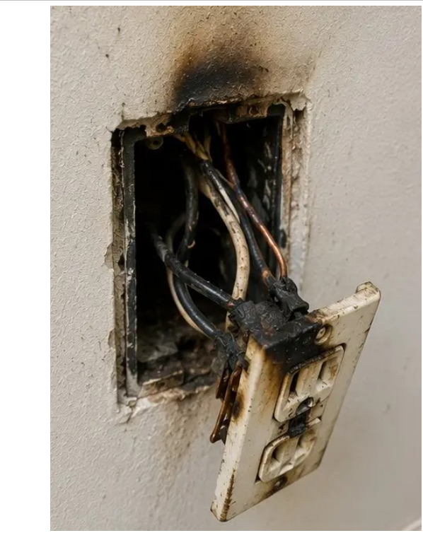
Foto №12 Schaden am elektrischen System bei der Inspektion erfasst
