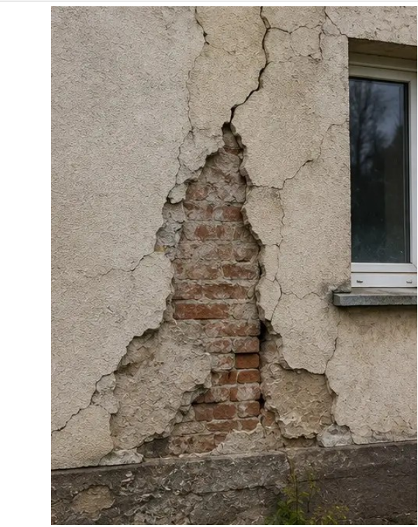
Foto №4 Außenwandschaden zur Bewertung dokumentiert
