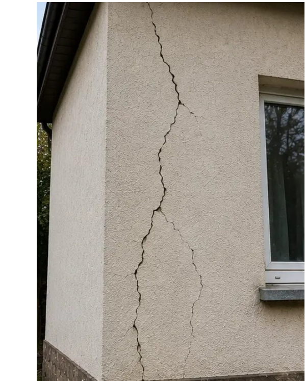
Foto №5 Riss in tragender Wand während der Inspektion dokumentiert
