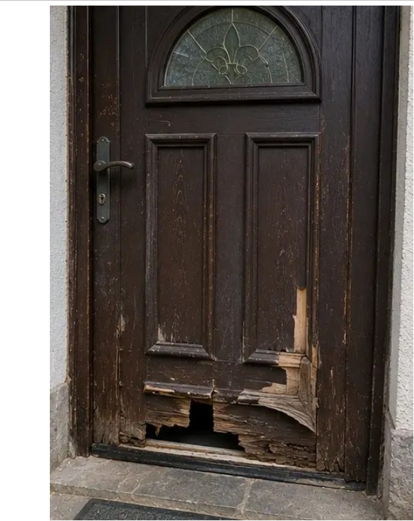
Foto №8 Beschädigte Eingangstür bei der Inspektion erfasst
