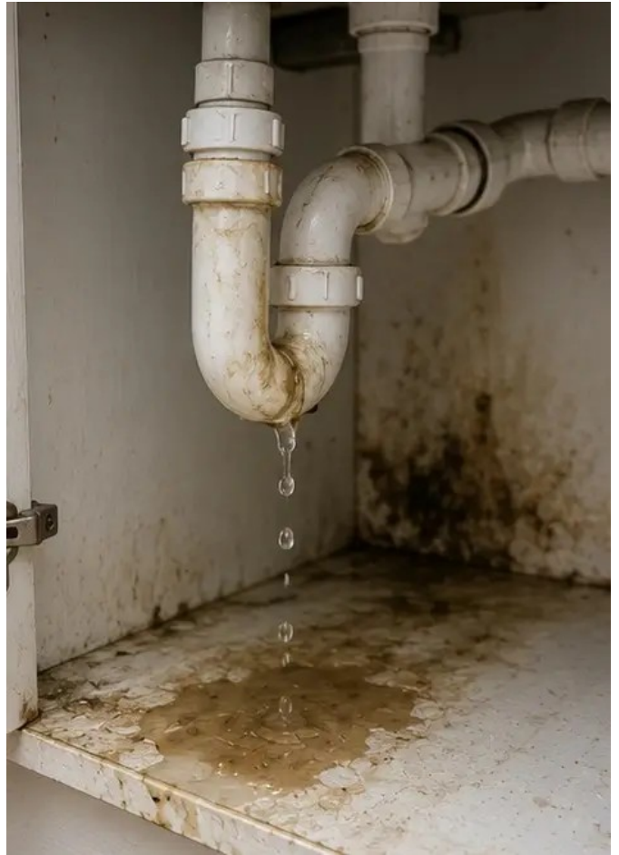
Foto №11 Schaden durch Rohrleitungsleckage dokumentiert
