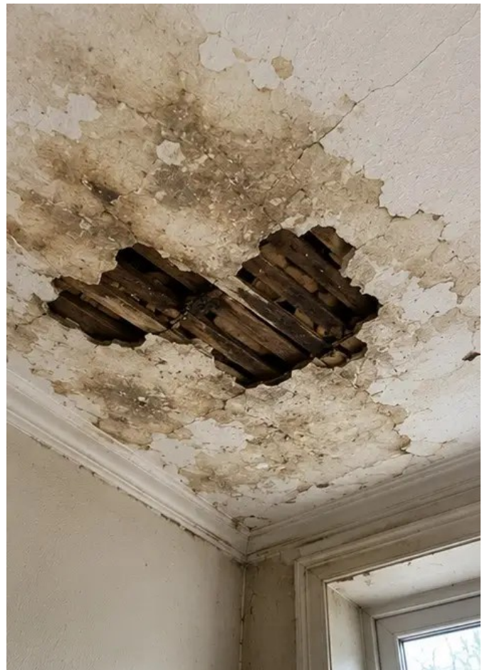
Foto №10 Deckenschaden identifiziert und erfasst
