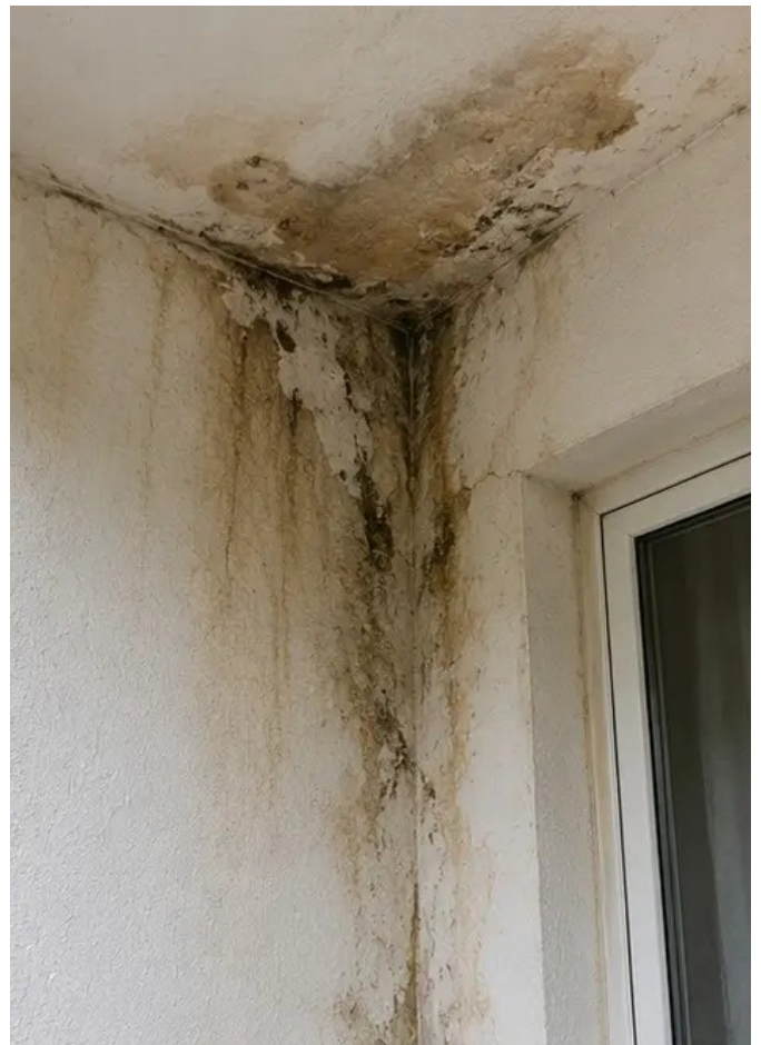
Foto №6 Wasserschadenbereich identifiziert und erfasst
