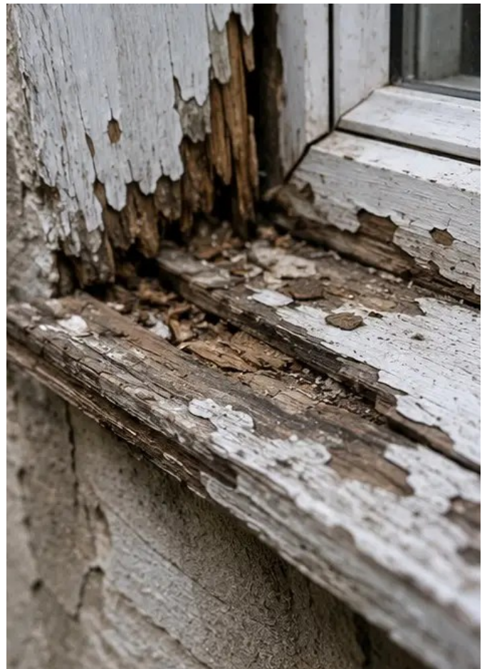
Foto №14 Nahaufnahme des festgestellten Schadens als Nachweis
