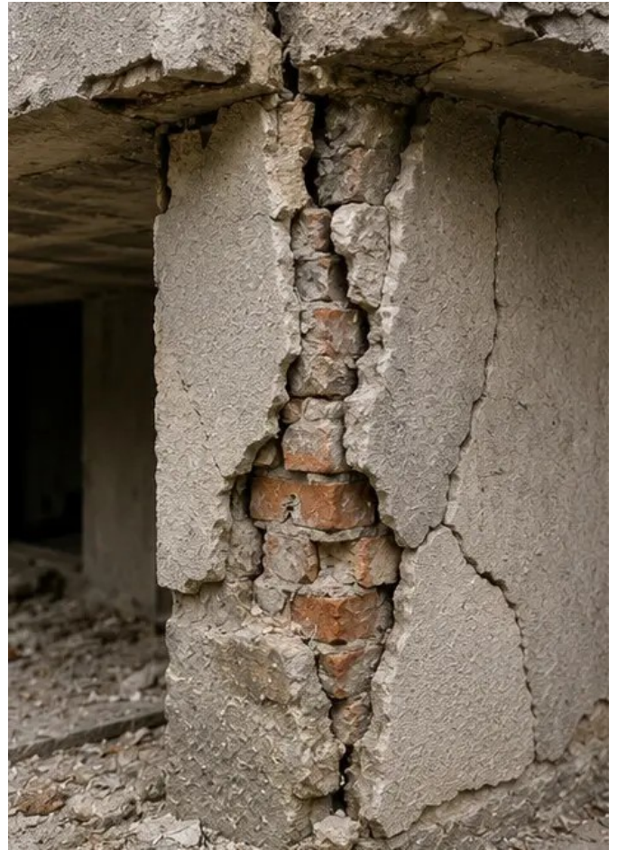
Foto №13 Detail des baulichen Schadens zur Bewertung dokumentiert
