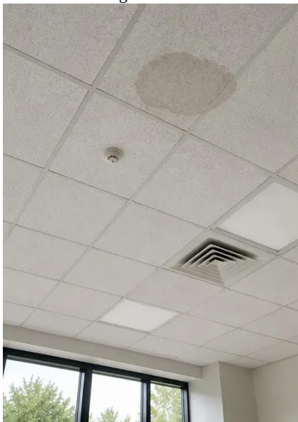
Photo #13. Zustand der Decke bei der Inspektion dokumentiert
