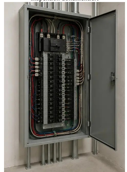
Photo #9. Zustand des Elektroverteilers dokumentiert
