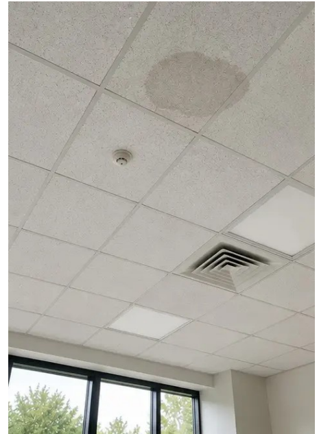
Photo #13. Zustand der Decke bei der Inspektion dokumentiert
