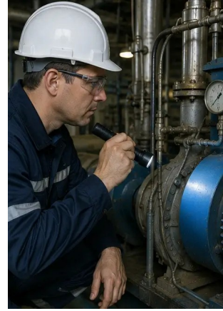
Foto nr.2. Mekanisk udstyrsinspektion afsluttet
