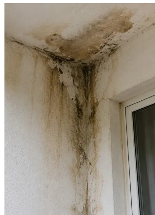
Photo #6. Vandskadeområde identificeret og registreret
