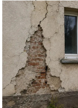
Photo #4. Udvendig vægskade dokumenteret til vurdering
