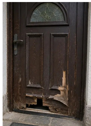
Photo #8. Beskadiget indgangsdør registreret under inspektion
