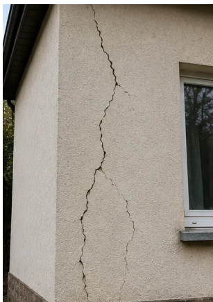
Photo #5. Revne i bærende væg dokumenteret under inspektion
