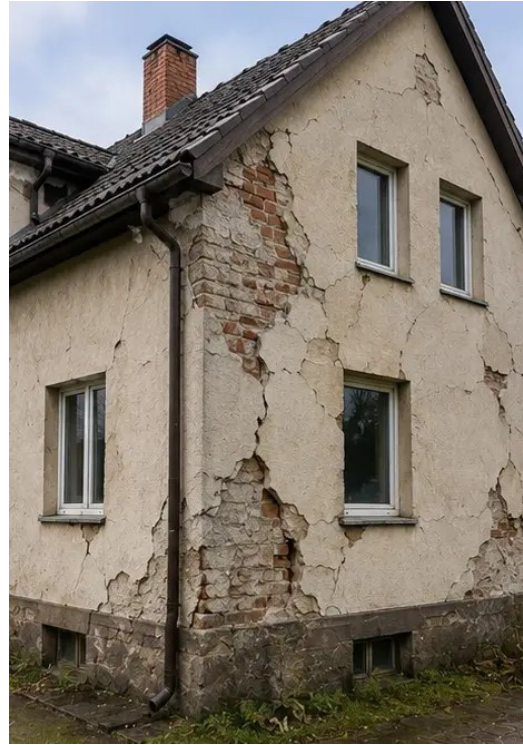
Foto nr.2 Oversigt over udvendige skader dokumenteret under inspektion
