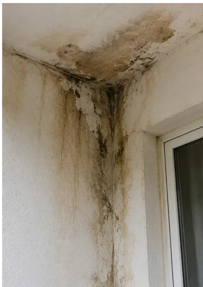
Foto nr.6 Vandskadeområde identificeret og registreret
