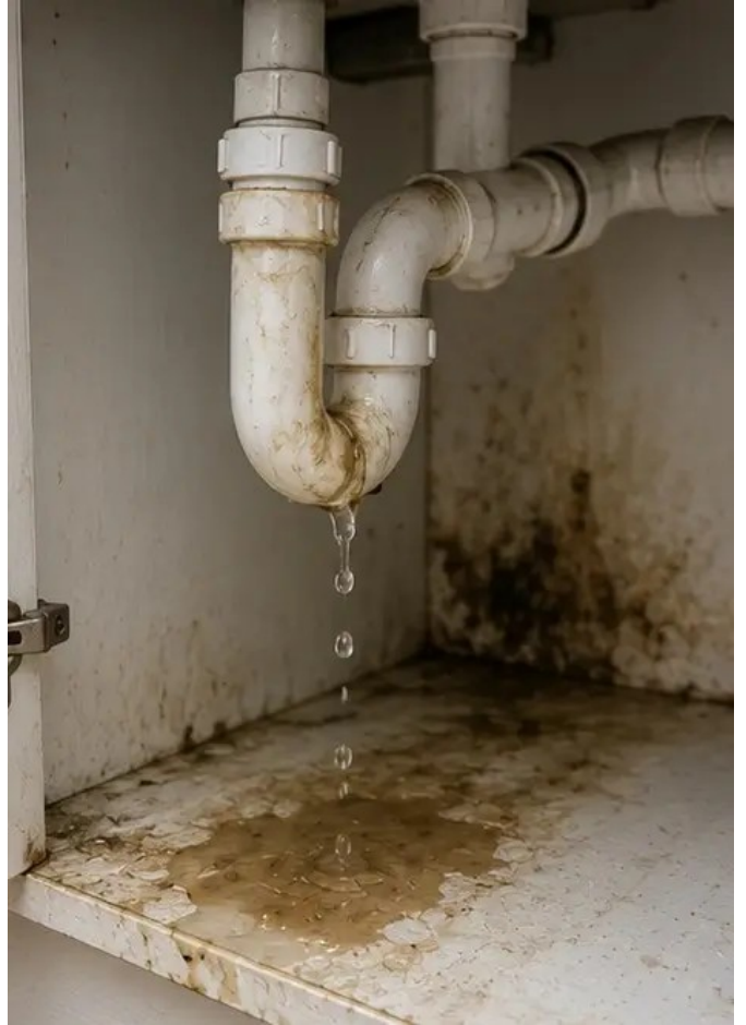
Foto nr.11 VVS-lækageskade dokumenteret
