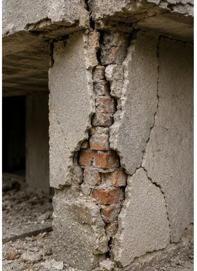
Foto nr.13 Detalje af konstruktionsskade dokumenteret til vurdering
