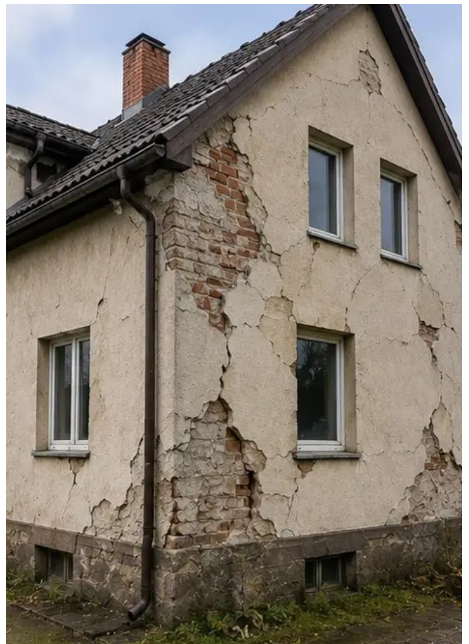
Foto nr.2 Oversigt over udvendige skader dokumenteret under inspektion
