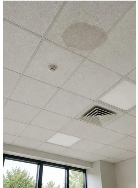
Photo #13. Loftets tilstand dokumenteret under inspektion
