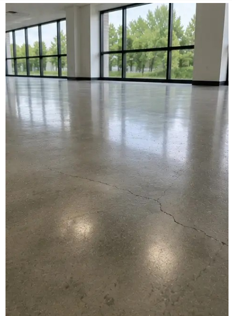
Photo #14. Gulvets tilstand vurderet og registreret
