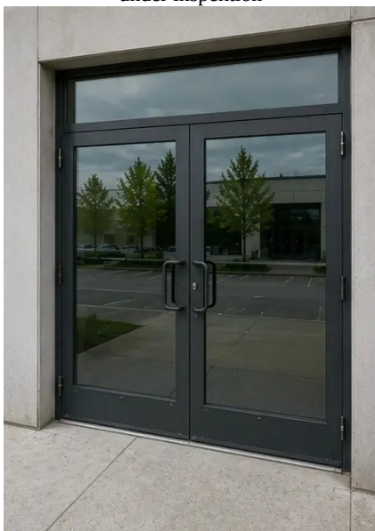
Photo #7. Dørenes tilstand inspiceret og registreret
