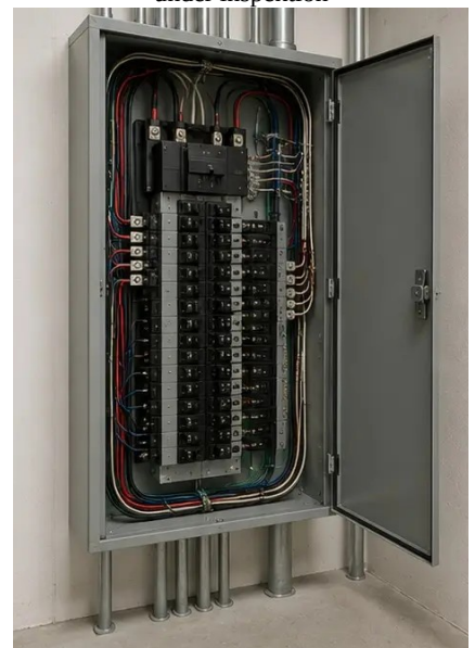
Photo #9. Eltavles tilstand dokumenteret
