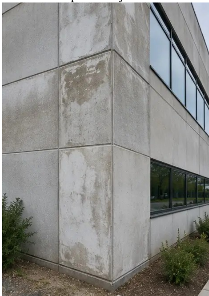
Photo #4. Ydervæggens tilstand registreret under inspektion
