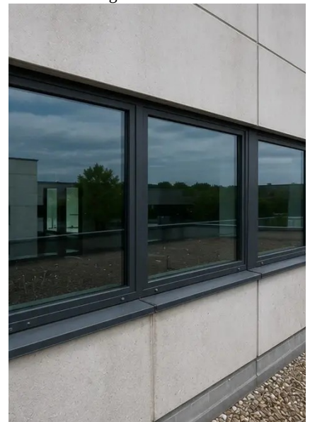
Photo #6. Vinduernes tilstand dokumenteret under inspektion
