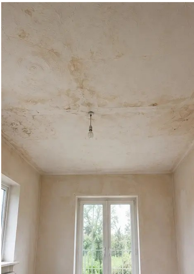
Foto nr.7 Loftets tilstand før renovering
