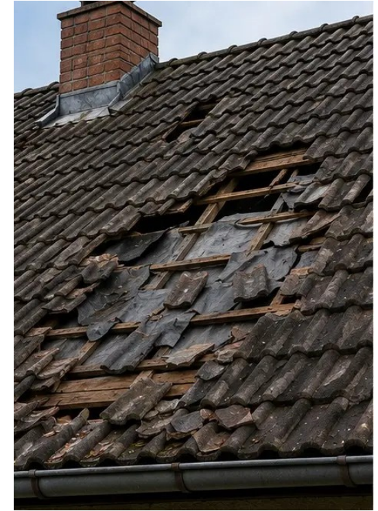
Fotografie č. 3 Poškozená oblast střechy identifikována a zaznamenána
