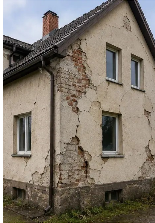
Fotografie č. 2 Přehled vnějších poškození zdokumentovaných během prohlídky
