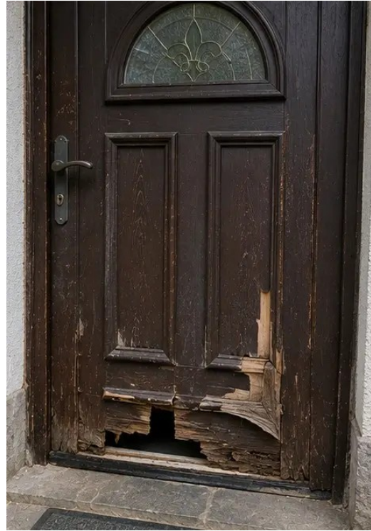
Fotografie č. 8 Poškozené vstupní dveře zaznamenány během prohlídky
