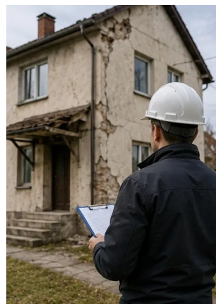
Photo #16. Souhrnná fotografie závěrečné prohlídky poškození
