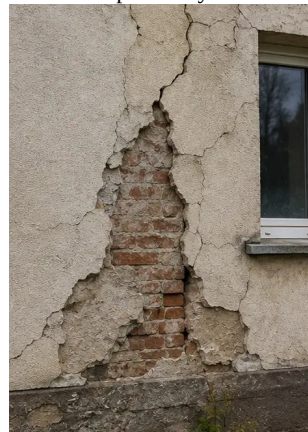
Photo #4. Poškození vnější zdi zdokumentováno pro posouzení
