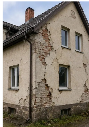
Photo #2. Přehled vnějších poškození zdokumentovaných během prohlídky
