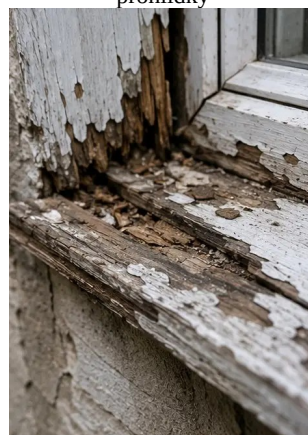
Photo #14. Detailní fotografie identifikovaného poškození
