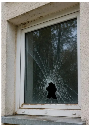
Photo #7. Poškozené okno zdokumentováno pro vyhodnocení
