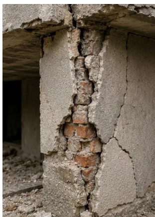
Photo #13. Detail konstrukčního poškození zdokumentován pro posouzení
