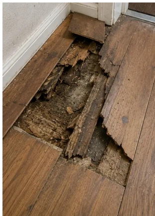
Photo #9. Poškozená podlaha zdokumentována během prohlídky
