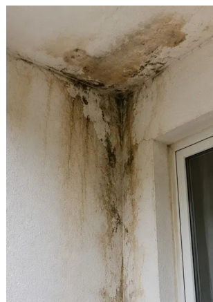
Photo #6. Oblast poškození vodou identifikována a zaznamenána
