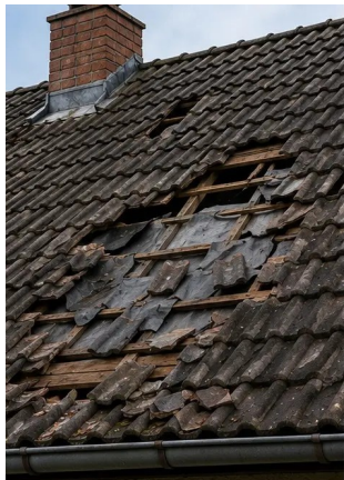
Photo #3. Poškozená oblast střechy identifikována a zaznamenána
