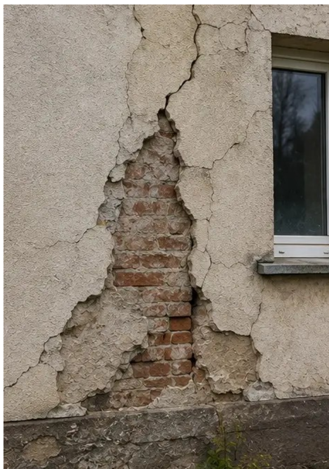
Fotografie č. 4 Poškození vnější zdi zdokumentováno pro posouzení
