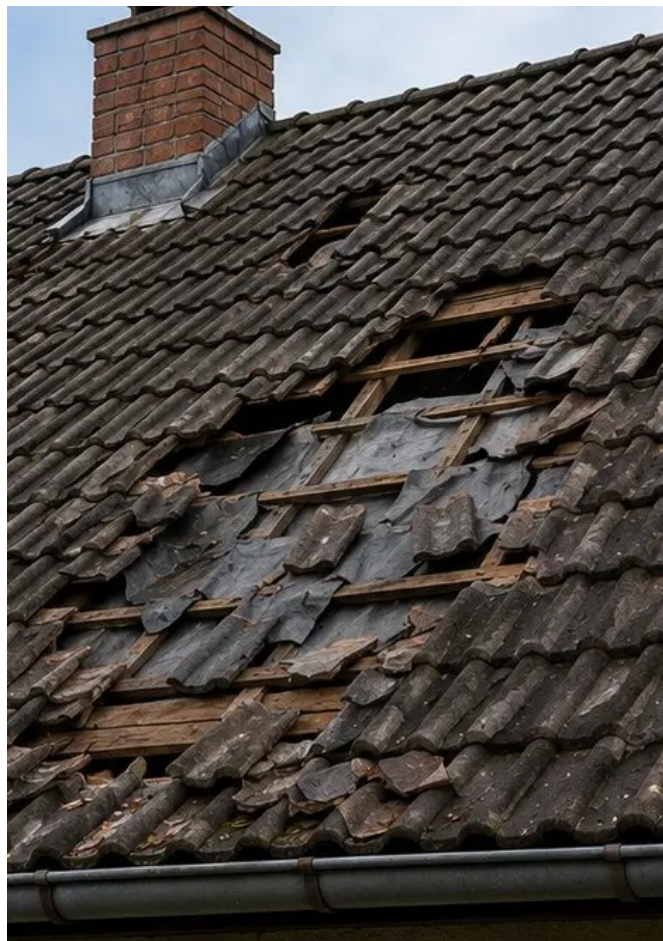
Fotografie č. 3 Poškozená oblast střechy identifikována a zaznamenána
