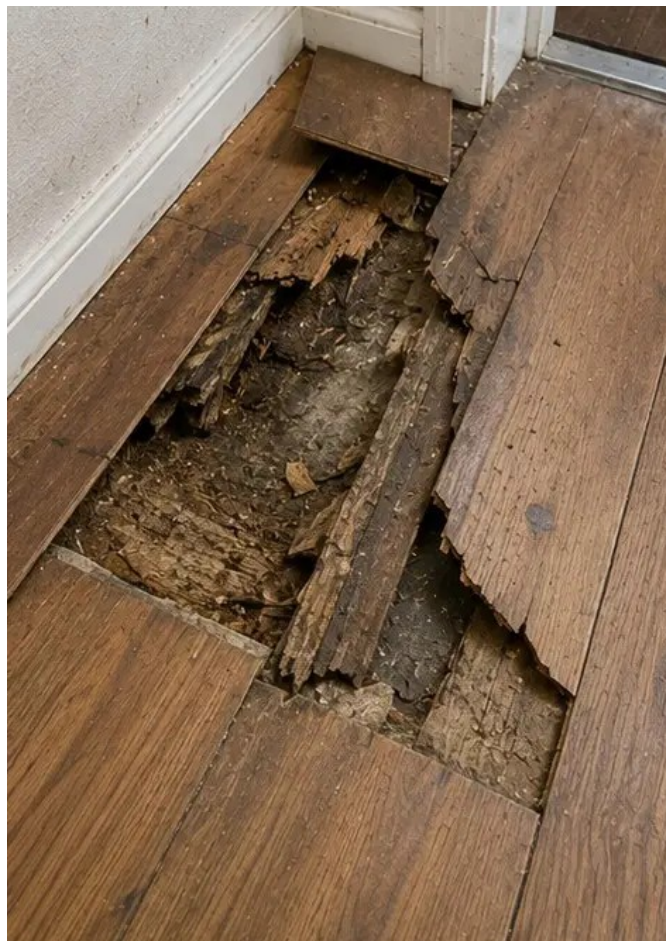
Fotografie č. 9 Poškozená podlaha zdokumentována během prohlídky
