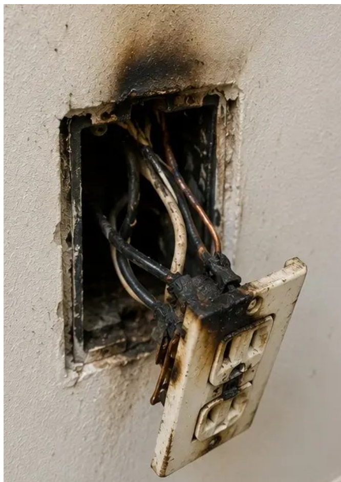
Fotografie č. 12 Poškození elektrického systému zaznamenáno během prohlídky
