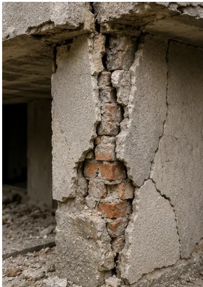
Fotografie č. 13 Detail konstrukčního poškození zdokumentován pro posouzení
