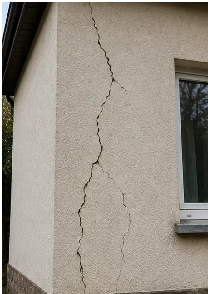
Fotografie č. 5 Trhlina v nosné zdi zdokumentována během prohlídky
