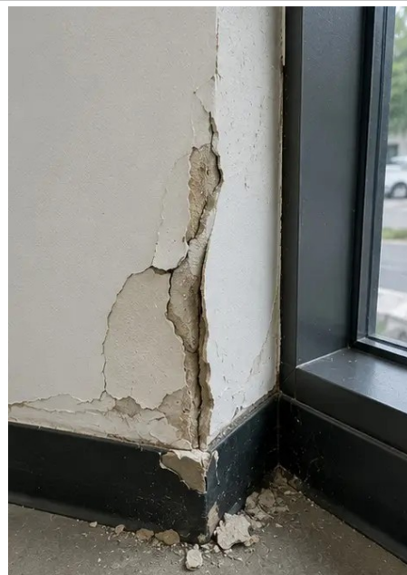
Photo #15. Identifikovaná závada zdokumentována pro další vyhodnocení
