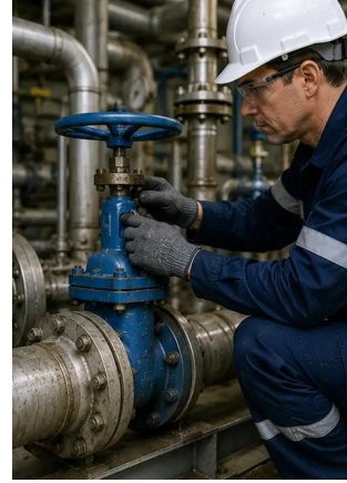
Fotografie č. 10. Stav ventilu posouzen během kontroly
