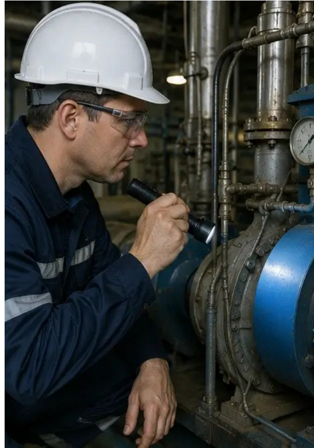
Fotografie č. 2. Kontrola mechanického zařízení dokončena
