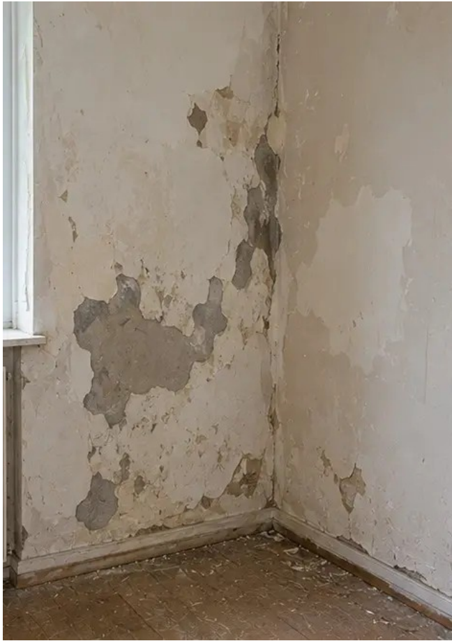
Fotografie č. 3 Stav zdi před opravou
