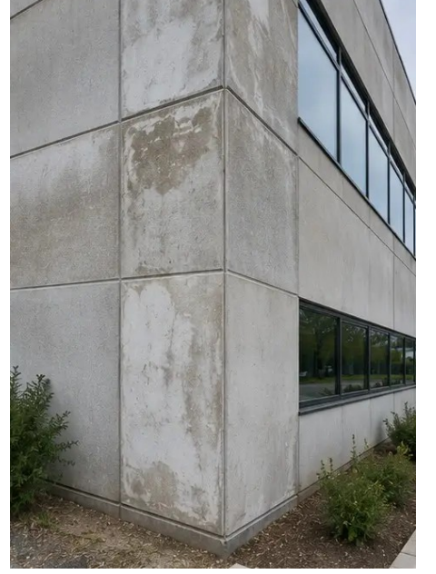
Photo #4. পরিদর্শনের সময় রেকর্ডকৃত বাহ্যিক দেয়ালের অবস্থা
