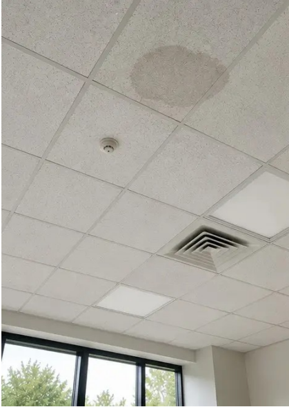
Photo #13. পরিদর্শনের সময় সিলিংয়ের অবস্থা নথিভুক্ত
