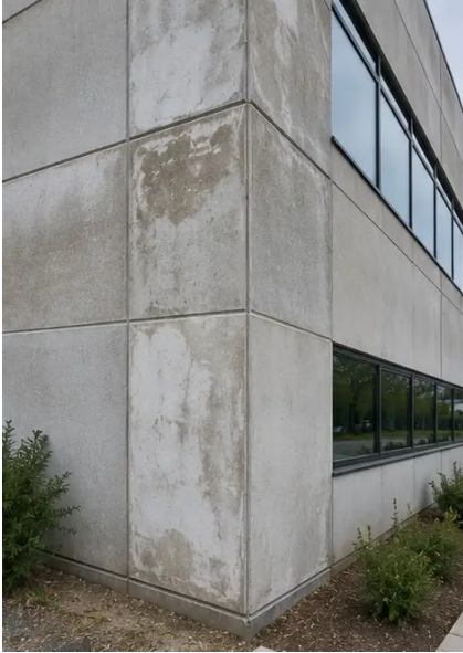
Photo #4. পরিদর্শনের সময় রেকর্ডকৃত বাহ্যিক দেয়ালের অবস্থা
