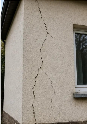
Photo #5. পরিদর্শনের সময় নথিভুক্ত স্ট্রাকচারাল দেয়ালের ফাটল
