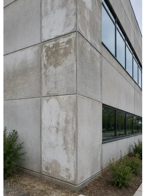
Photo #4. Състояние на външните стени, записано при инспекцията
