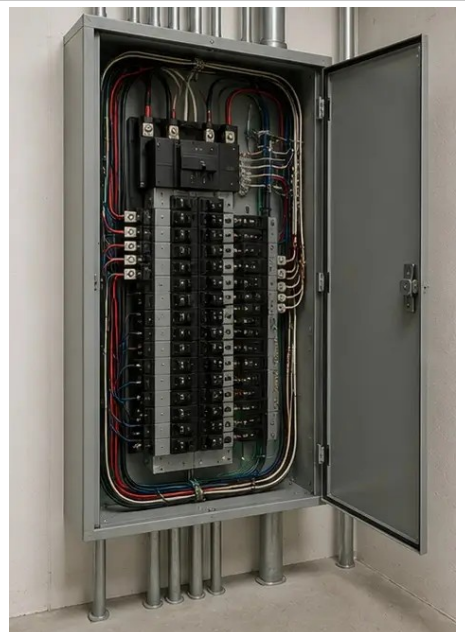
Photo #9. Състояние на електрическото табло, документирано
