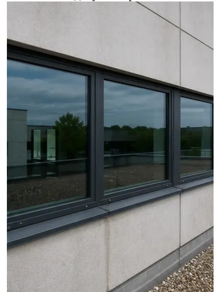
Photo #6. Състояние на дограмата, документирано при инспекцията
