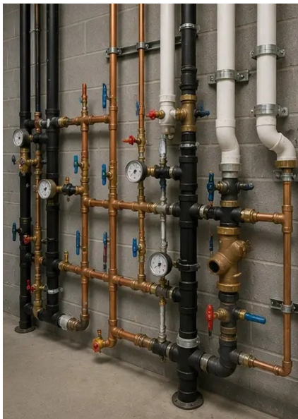
Photo #10. Инспекция на водопроводната система завършена
