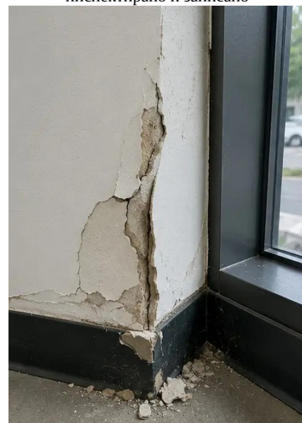
Photo #15. Идентифициран дефектен участък, документиран за допълнителна оценка
