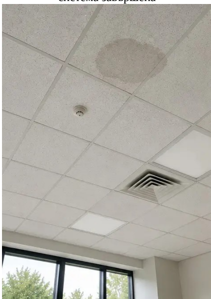
Photo #13. Състояние на тавана, документирано при инспекцията
