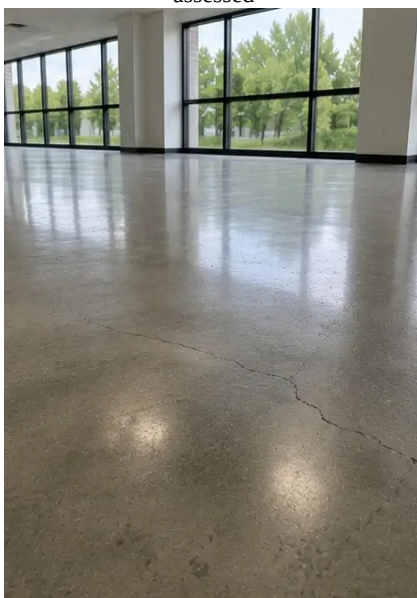
Photo #14. Състояние на подовете, оценено и записано
