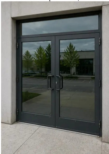
Photo #7. Състояние на вратите, инспектирано и записано
