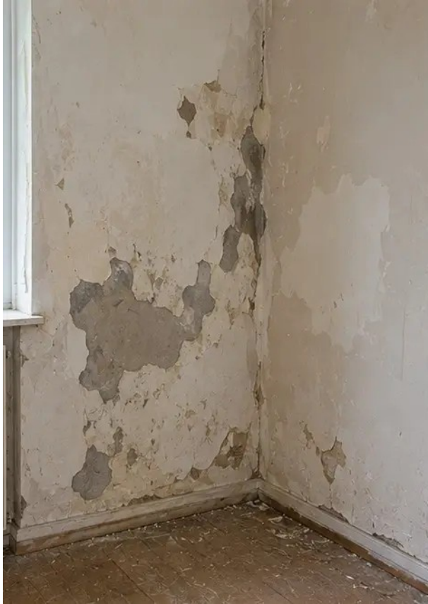
Снимка №3 Състояние на стената преди ремонтни дейности
