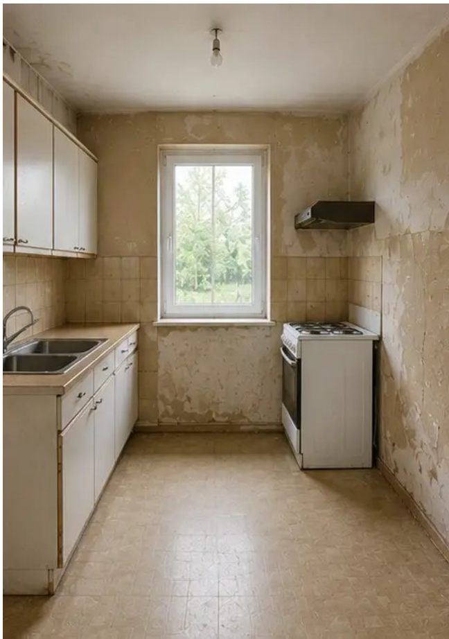
Снимка №11 Състояние на кухнята преди ремонт
