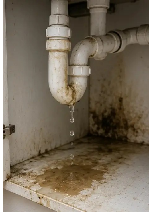
Снимка №11 Щети от теч на водопровод, документирувани
