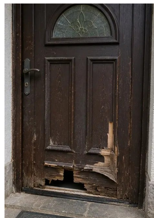
Photo #8. Повредена входна врата, записана при инспекцията
