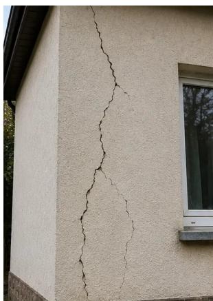
Photo #5. Пукнатина в носеща стена, документирана при инспекцията
