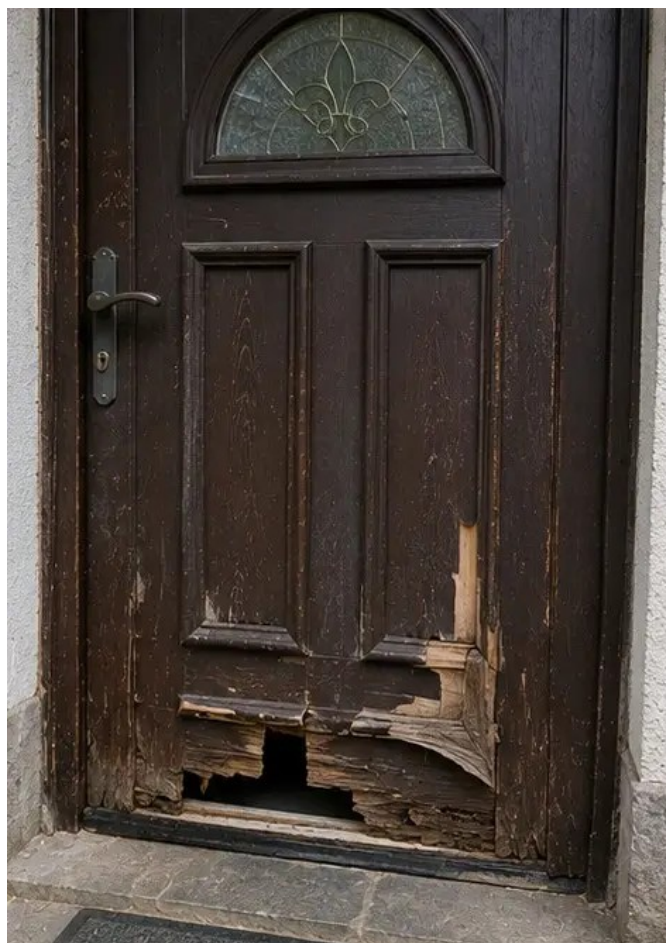
Снимка №8 Повредена входна врата, записана при инспекцията
