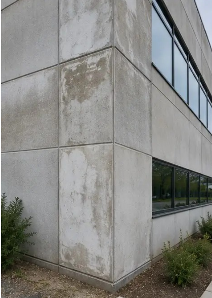
Photo #4. حالة الجدار الخارجي المسجلة أثناء الفحص
