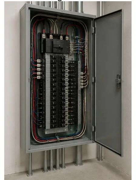
Photo #9. حالة لوحة الكهرباء الموثقة
