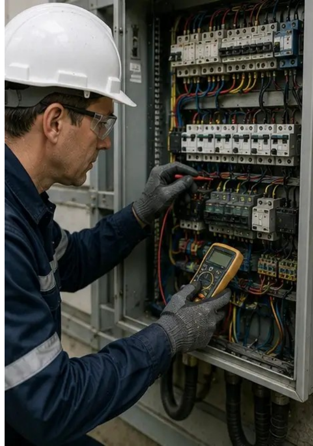
صورة رقم 5. فحص الخزانة الكهربائية المنفذ
