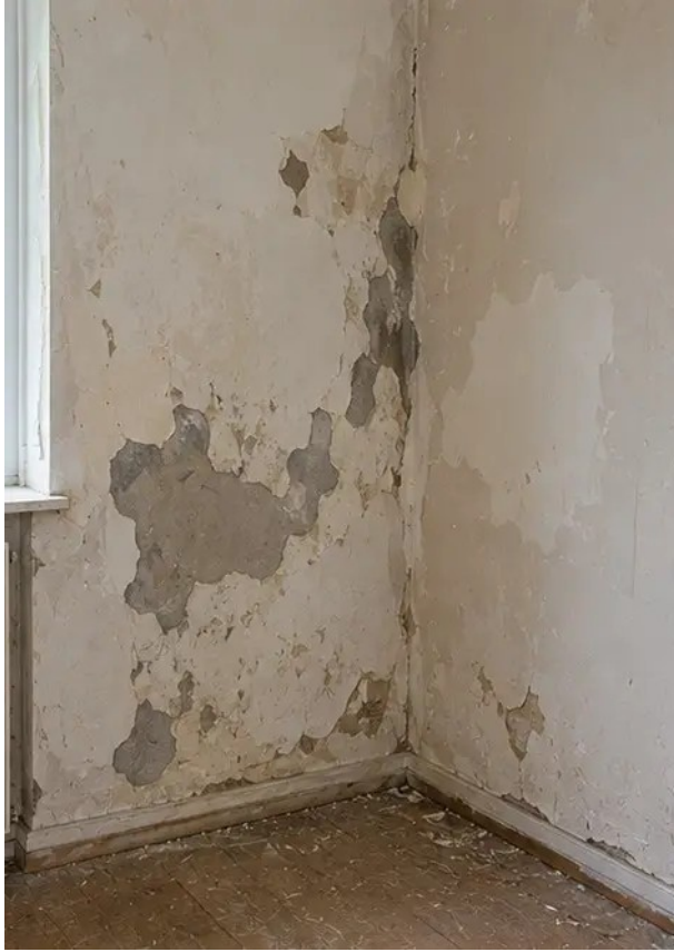
صورة رقم 3 حالة الجدار قبل أعمال الإصلاح
