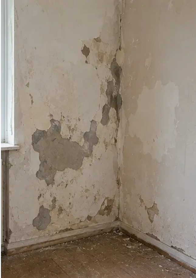
صورة رقم 3 حالة الجدار قبل أعمال الإصلاح
