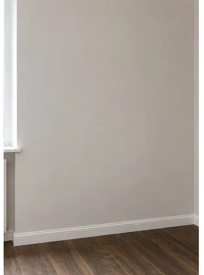
صورة رقم 4 حالة الجدار بعد أعمال الإصلاح
