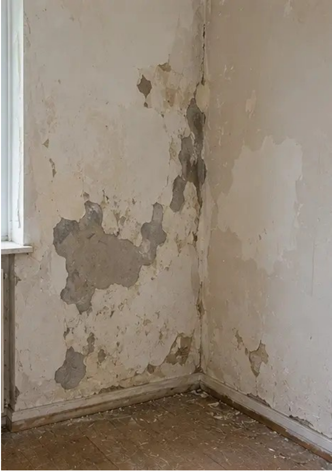
صورة رقم 3 حالة الجدار قبل أعمال الإصلاح
