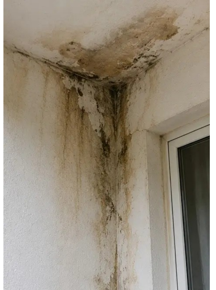
صورة رقم 6 منطقة أضرار المياه المحددة والمسجلة
