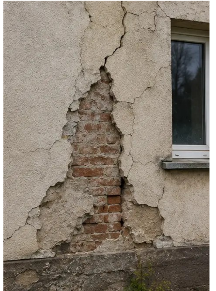
صورة رقم 4 أضرار الجدار الخارجي الموثقة للتقييم
