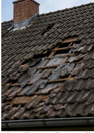
Photo #3. منطقة السقف المتضررة المحددة والمسجلة
