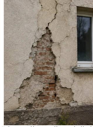
Photo #4. أضرار الجدار الخارجي الموثقة للتقييم
