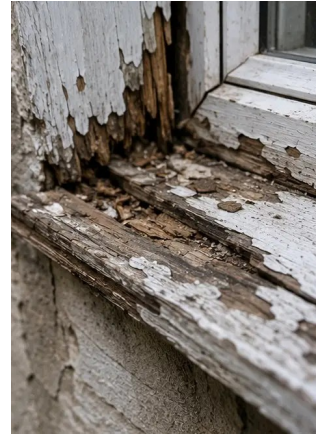
Photo #14. صورة مقربة توثق الضرر المحدد
