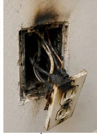
Photo #12. أضرار النظام الكهربائي المسجلة أثناء الفحص
