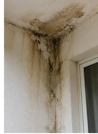
Photo #6. منطقة أضرار المياه المحددة والمسجلة
