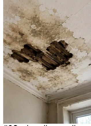
Photo #10. أضرار السقف المحددة والمسجلة
