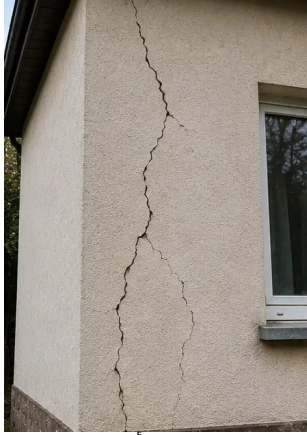
Photo #5. شخ الجدار الإنشائي الموثق أثناء الفحص
