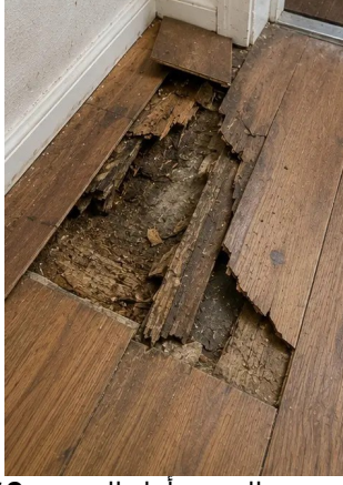
Photo #9. الأرضية المتضررة الموثقة أثناء الفحص
