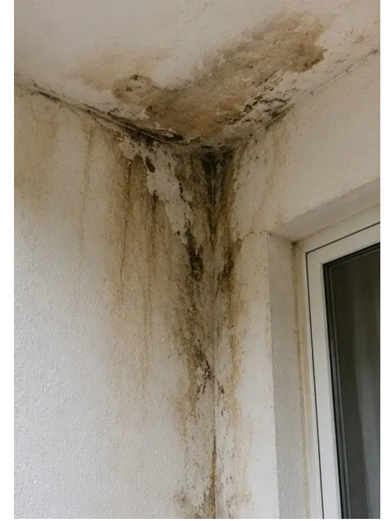
صورة رقم 6 منطقة أضرار المياه المحددة والمسجلة
