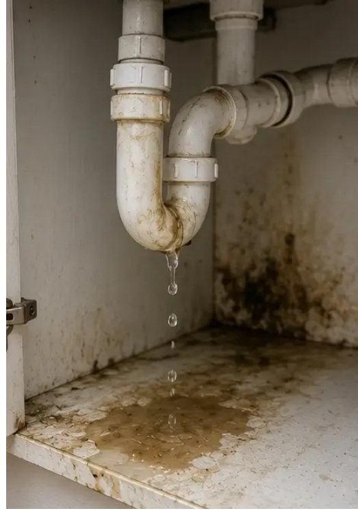
صورة رقم 11 أضرار تسرب الشبكة الموثقة
